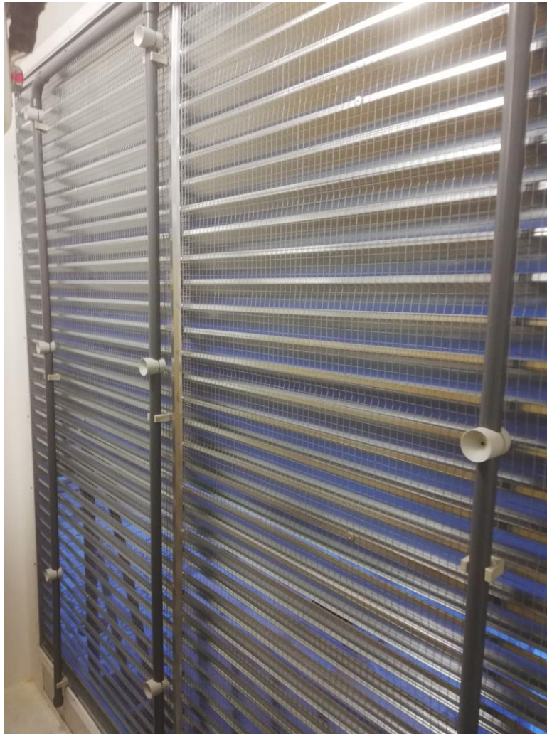
Abbildung der Ansaugtrichter des Rauchgas-Ansaug-Systems
